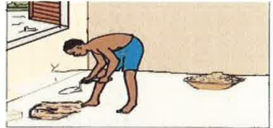
Colmater les trous et fissures des murs et du toit
