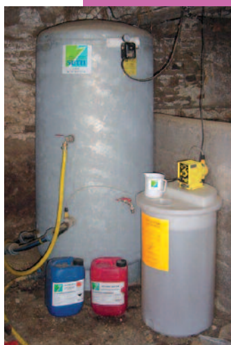
Pompe à chlore
