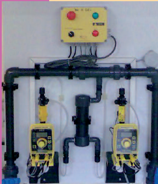
Installation dioxyde de chlore
